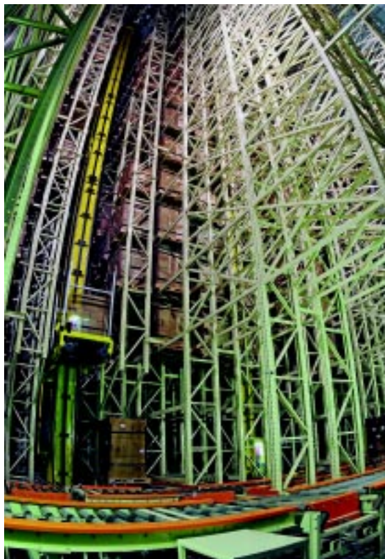
O armazém conta com transelevadores e transportadores horizontais de correntes
