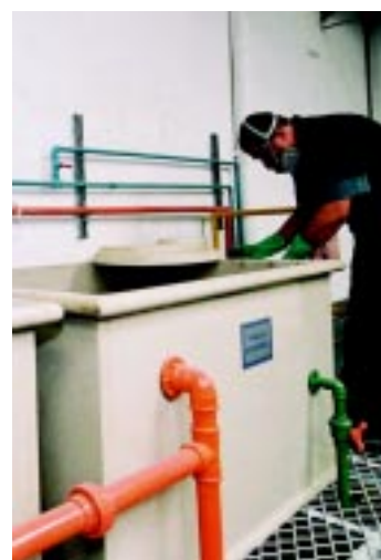
Oficina conta com Estação de Tratamento de Efluentes
