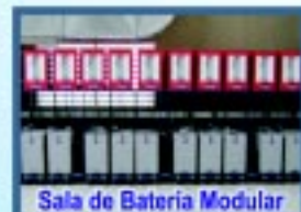
Sala de Bateria Modular
