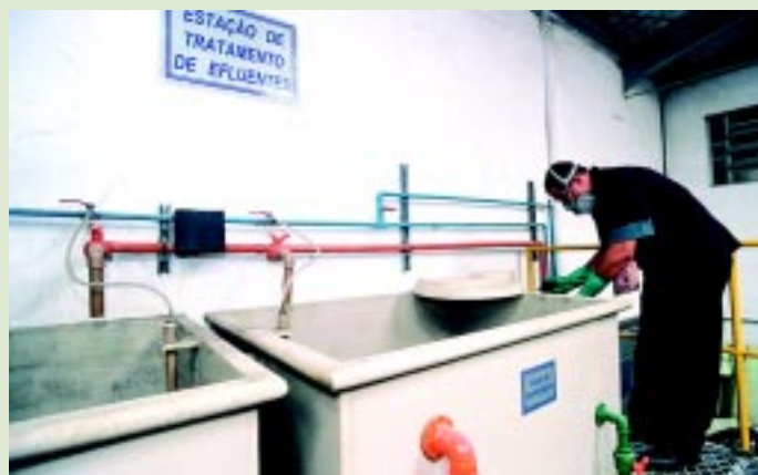
Estações de tratamento de resíduos e efluentes são fundamentais para a solução de ácido sulfúrico
